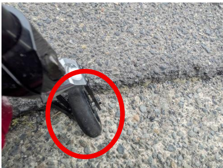
エプロン部より車道のほうが上がっているので、車いすのキャスターがひっかかりました。
